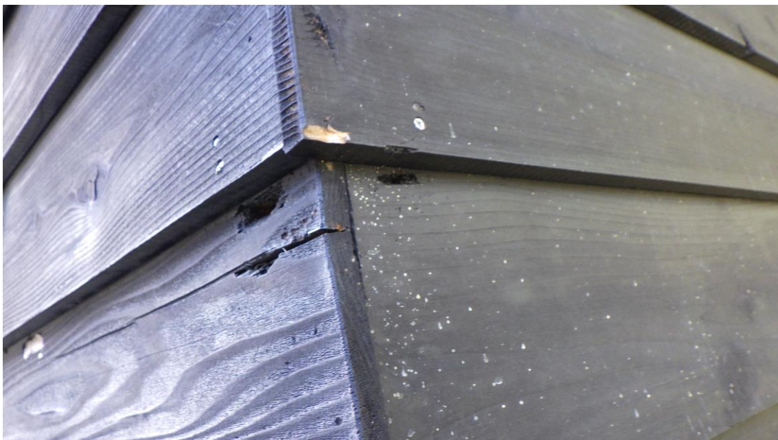
キツキが痛めた外壁の補修作業
